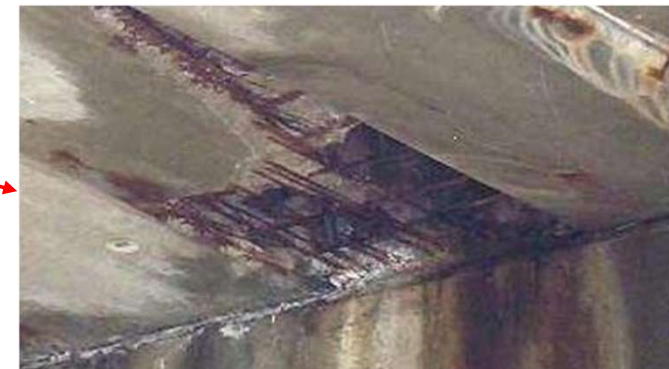
コンクリートの剥落
