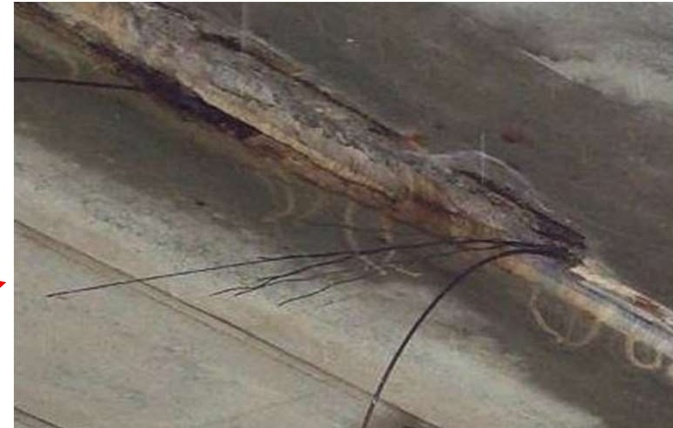
PC鋼材の破断
